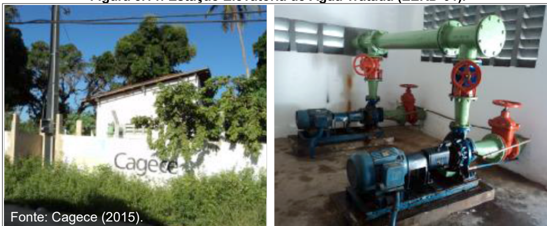
Figura 5.14: Estação Elevatória de Água Tratada (EERD-01).
