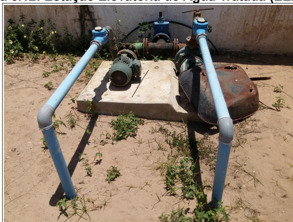
Figura 5.12: Estação Elevatória de Água Tratada (EEAT-03).
