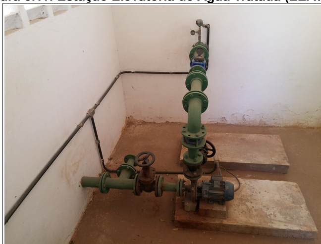
Figura 5.11: Estação Elevatória de Água Tratada (EEAT-02).
