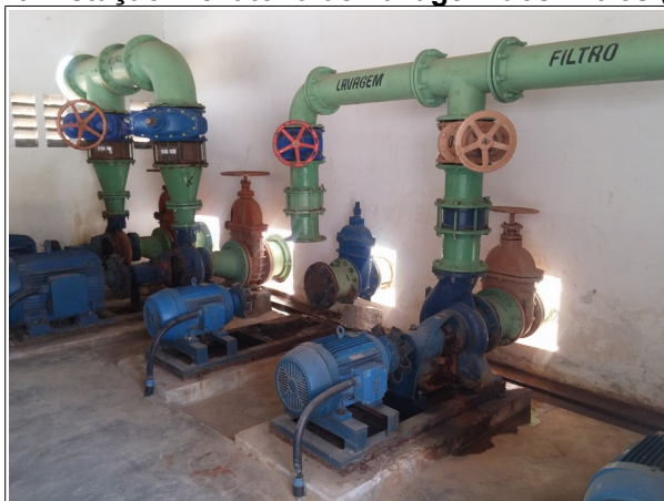
Figura 5.13: Estação Elevatória de Lavagem dos Filtros (EELF-01).
