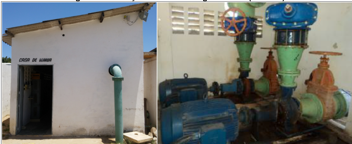
Figura 5.10: Estação Elevatória de Água Tratada (EEAT-01).
